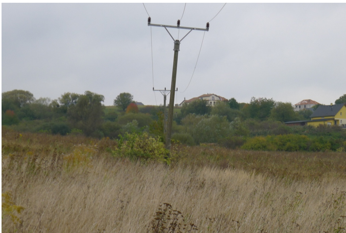
Obr. 6 Vychýlený stĺp 110 kV elektrického vedenia na hranici potenciálneho a aktívneho zosuvu.
